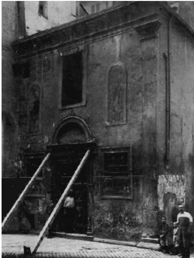
Facciata puntellata (tratta da: A. Muñoz, Nelle chiese di Roma. Ritrovamenti e restauri , in Bollettino d'arte , 1912, pp. 383-395)
